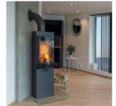
Installation contre un mur
